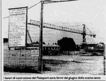
I lavori di costruzione del Palasport sono fermi dal giugno dello scorso anno
